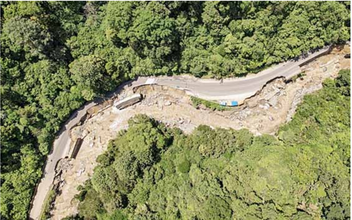
Kondisi jalan yang putus di sekitar Lembah Anai akibat diterjang galodo. Jalan ini menghubungkan Kota Padang – Bukittinggi dan Tanah Datar (Foto Antara)
