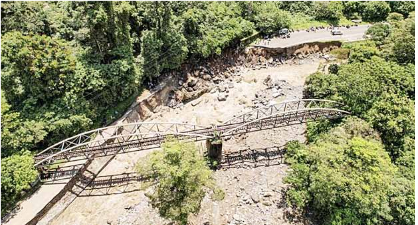
Kondisi jalan yang putus di sekitar Lembah Anai akibat diterjang galodo. Jalan ini menghubungkan Kota Padang – Bukittinggi dan Tanah Datar (Foto Antara)
